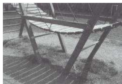
Spodní dřevěná vodorovná vzpěra velmi nevhodně umístěna, volný prostor mezi vzpěrou a rampou umožňuje zachycení hlavy
