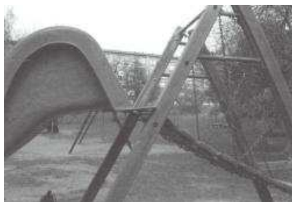
Velmi chybné napojení skluzu k rampě, vznikl nebezpečný prostor, kde se dítě nemá za co přidržet
